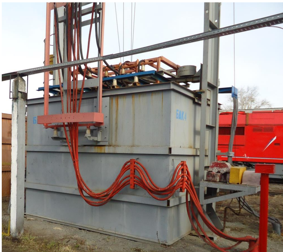
Рисунок 3.21 – Жидкостной нагрузочный реостат станции реостатных испытаний
